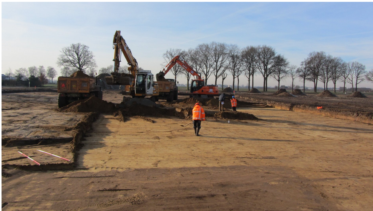
Figuur 4. Foto van de aanleg van het vlak. Met twee graafmachines wordt het vlak in stroken van het noordoosten naar het zuidwesten aangelegd.
